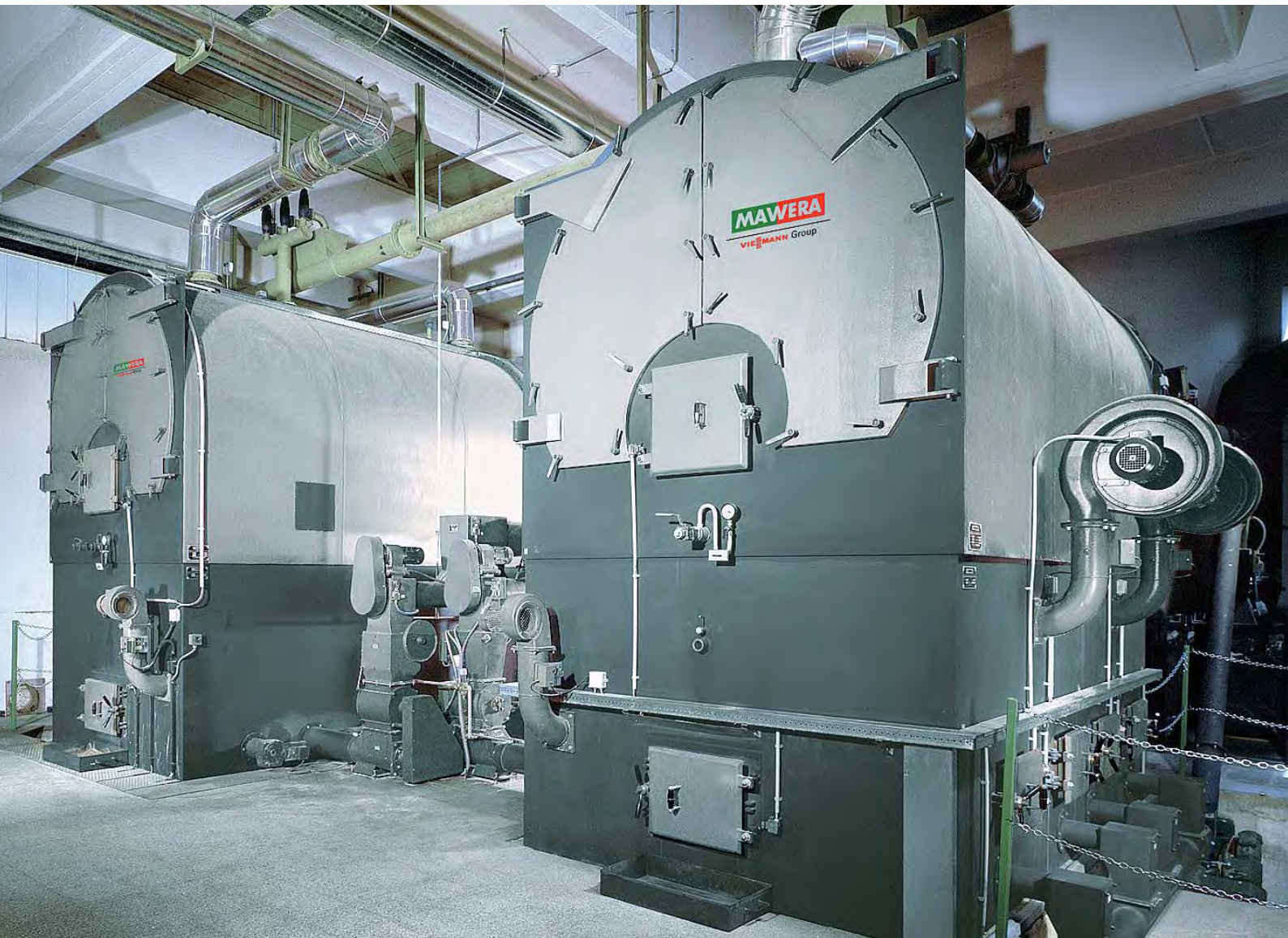
2 x Unterschubfeuerung FU 2500 RA, Mosser Leimholzbau, Randegg, Österreich
