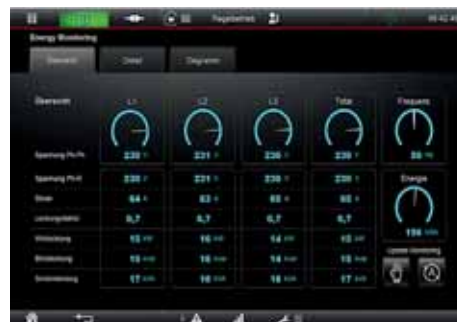
Auf einen Blick zeigt das Energie-Monitoring die aktuellen Leistungen der Kesselanlage.
