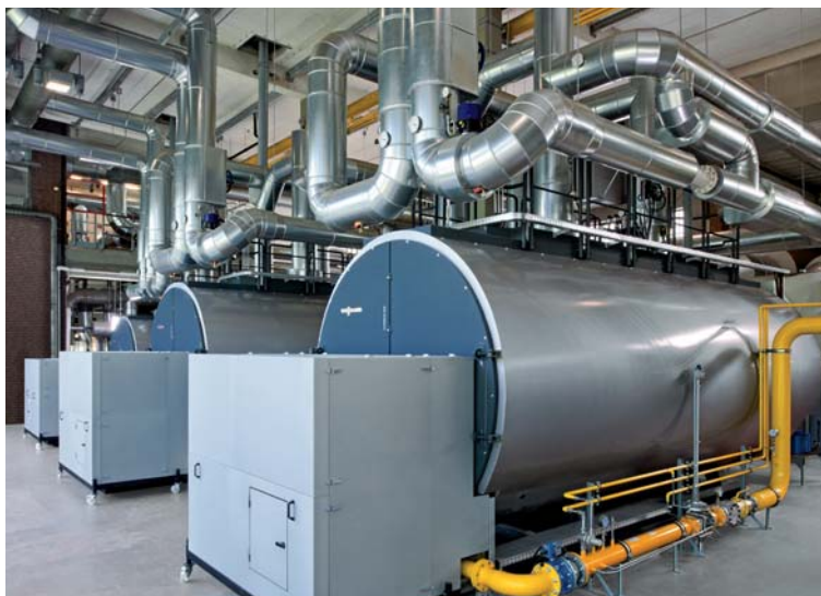
Drei Niederdruck-Heißwassererzeuger Vitomax LW leisten zusammen 32 MW
