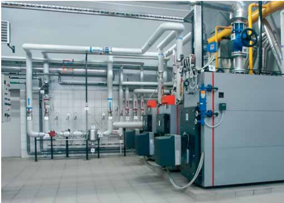
Typische Anwendung für kleinere Gewerbe: hier der Einsatz eines Vitoplex LS (vorne) und zwei Vitocrossal Heizkesseln
