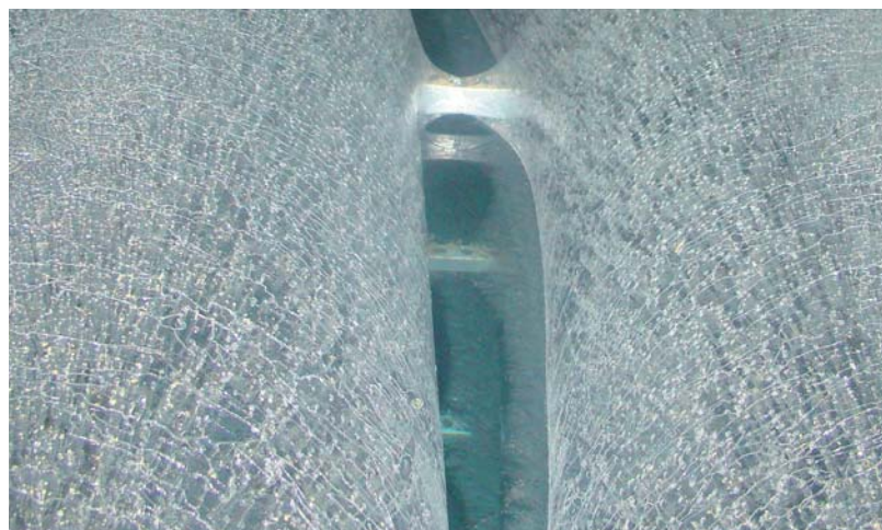
Eisbildung um den Wärmeüberträger im Eisspeicher
